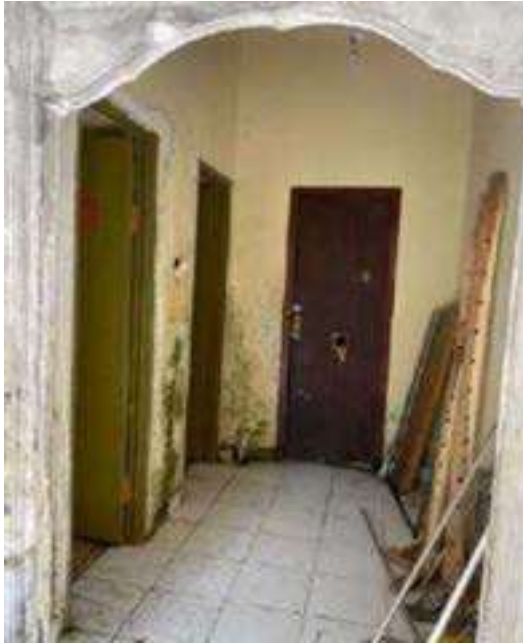
Gambar 12. Kondisi Toilet SD No. 5 Gegelang
