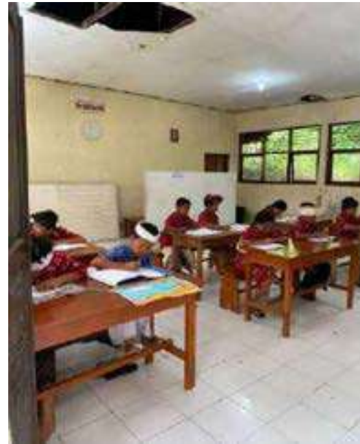
Gambar 13. Kondisi Ruang Kelas SD No. 5 Gegelang
